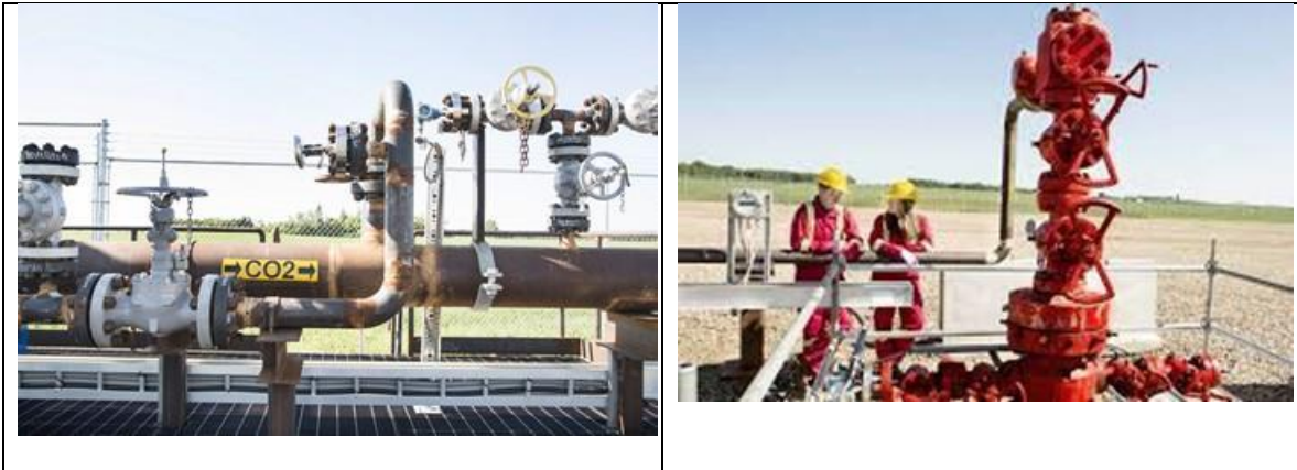
Figura 27 Vistas de la planta de Quest (complejo, unidad CCS, tuberías, inyector al reservorio)
