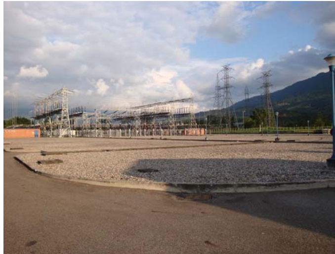
Figura 15. Espacio para la futura bahía de línea de 230 kV en la subestación Guatiguara
