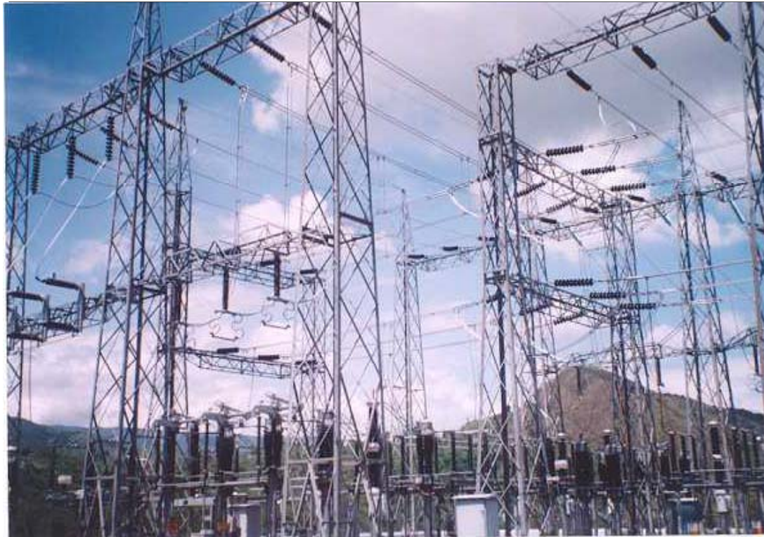
Foto N° 5 (S/E Betania). Vista barraje de 115 kV.
