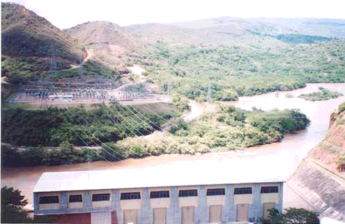
Foto N° 9 (S/E Betania). Desde costado oriental. Subestación. Salida del circuito hacia El Bote y alimentación desde la casa de máquinas.
