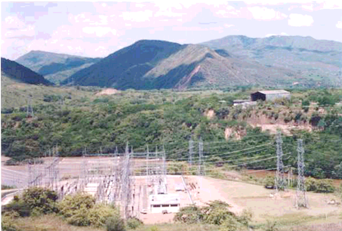
Foto N° 10 (S/E Betania). Desde costado sur (lomo de la presa). Subestación. Torre de llegada de líneas provenientes de la casa de máquinas y torre de salida línea hacia El Bote.
