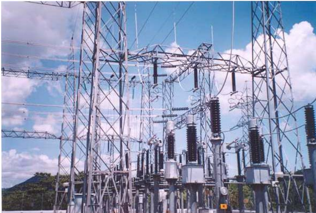
Foto N° 6 (S/E Betania). Vista barraje de 115 kV salida del circuito hacia Altamira.
