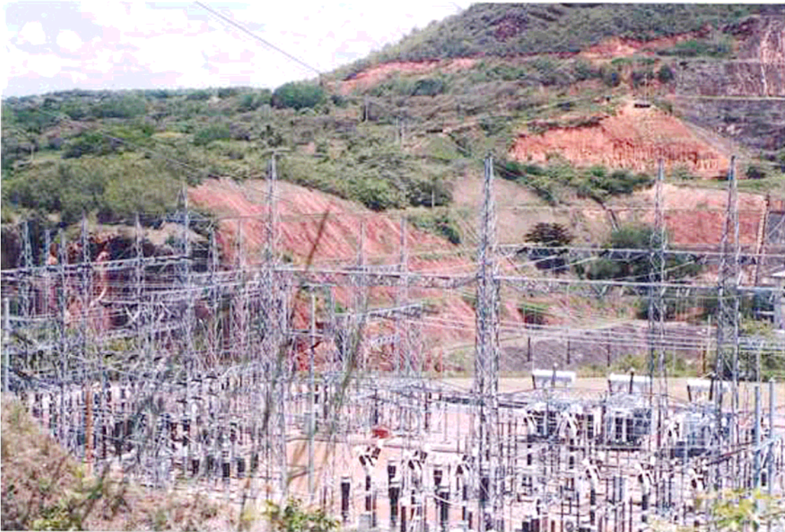
Foto N° 13 (S/E Betania). Desde costado occidental. Vista patio de 115 kV.
