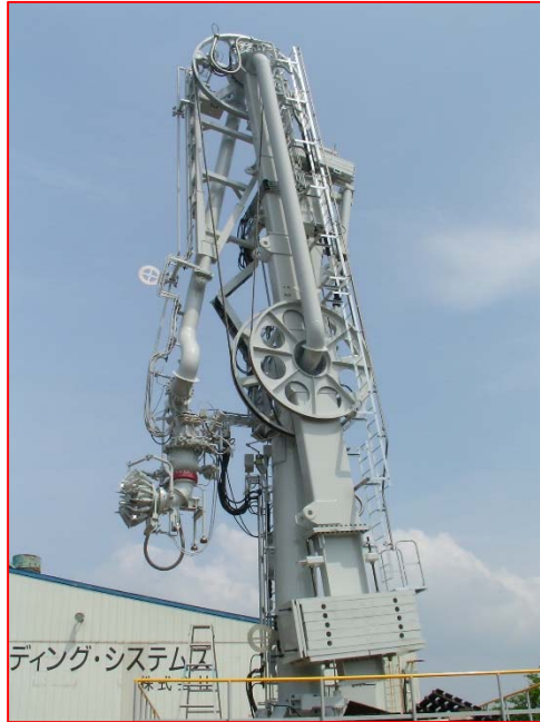
Figura: Brazo de descarga de GNL
