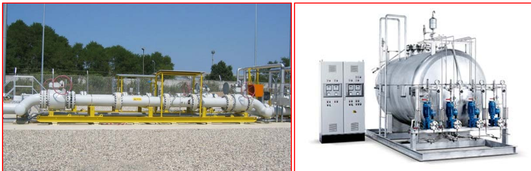
Figura: Estación de medida de gas natural (izda.). Equipo dosificación odorizante (dcha.)
