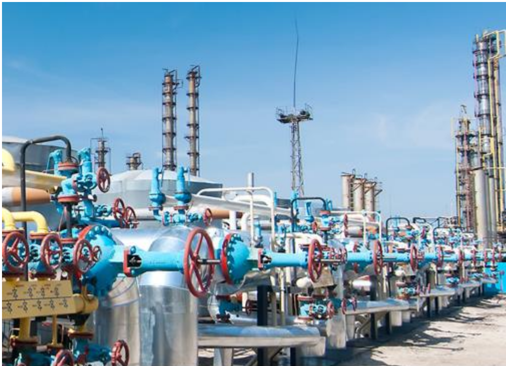
PLANTA DE TRATAMIENTO DE GAS DE CUSIANA CNO--Gas
