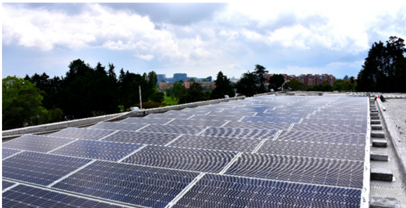
Figura 1. Instalación fotovoltaica en el techo de la facultad de medicina de la Universidad Nacional sede Bogotá [1].
