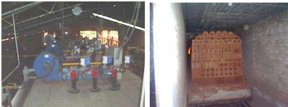
Figura 38. Quemadores de gas y carbón en horno tunel (Izq) -Descarga (Der)
