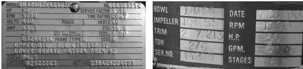
Figura 12.1 Placa de característica del motor y la bomba
