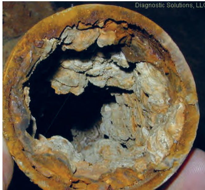
Figura 4.2 Tubería de distribución de agua con tuberculación visible (cortesía de Diagnostic Solutions)
