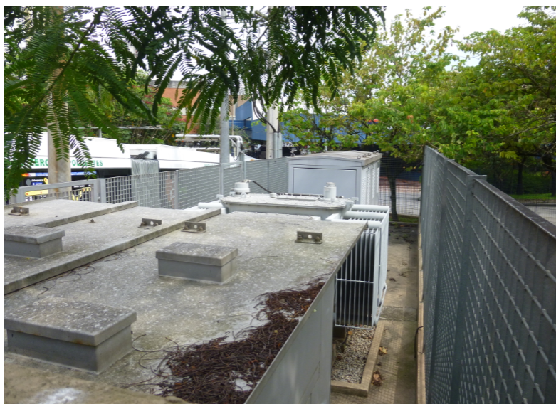
Fotografía 5-4. Subestación eléctrica para punto de recarga en ruta (Velandia, 2014)
