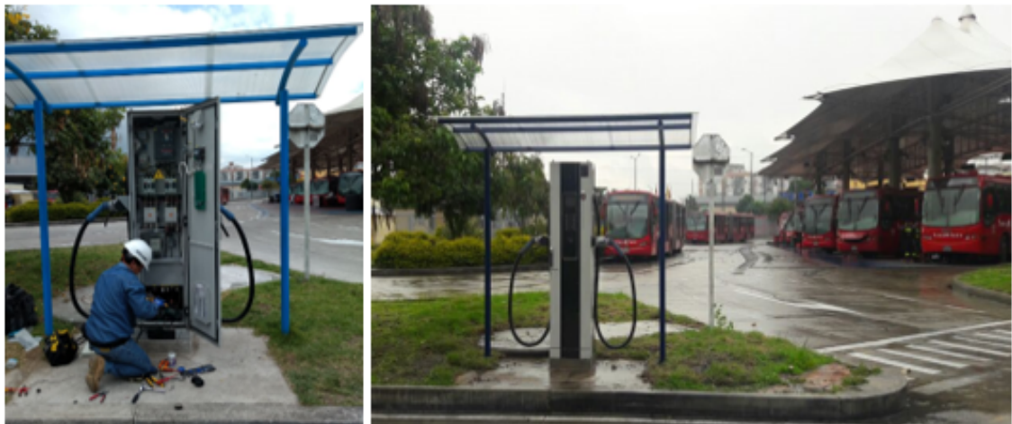
Fotografía 5-2. Estación de recarga para bus eléctrico articulado Transmilenio. (Velandia, 2018)
