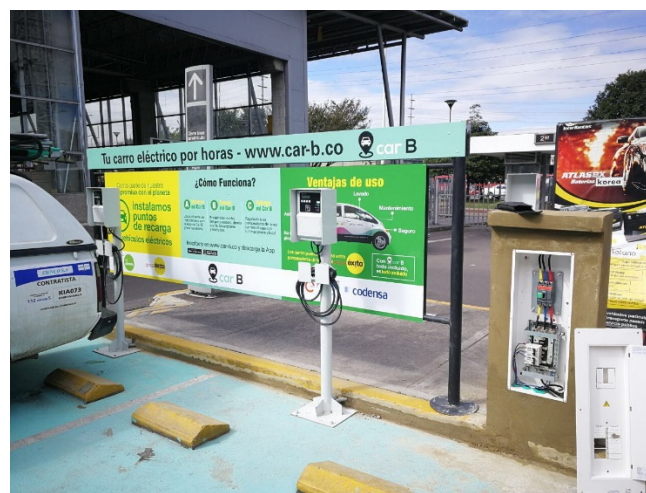
Fotografía 2-12. Estaciones de recarga pública en parqueaderos Bogotá (Melo, 2018)
