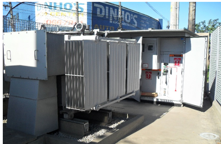
Fotografía 2-7. Subestación eléctrica en ruta para buses, Sao Paulo (Velandia, 2016)
