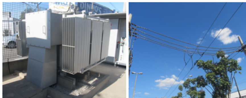
Fotografía 5-6. Subestación de tracción y alimentación para catenarias, Sao Paulo. (Velandia, 2015)
