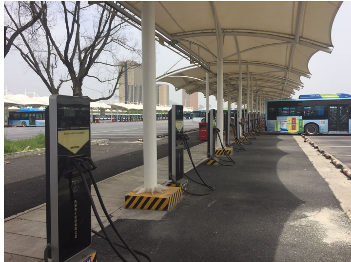
Fotografía 2-8. Patios de recarga flotas de buses en China (Cárdenas, 2019)
