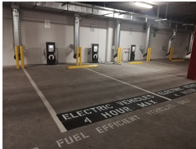
Fotografía 2-5. Estación de recarga en centro de educación San Diego (Velandia, 2019)
