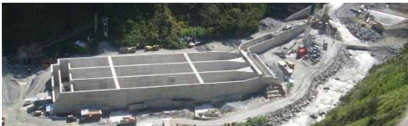
Proyecto Amoyá. Panorámica Captación. Fuente: ISAGEN.
